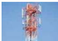
Базовая станция сотовой связи
